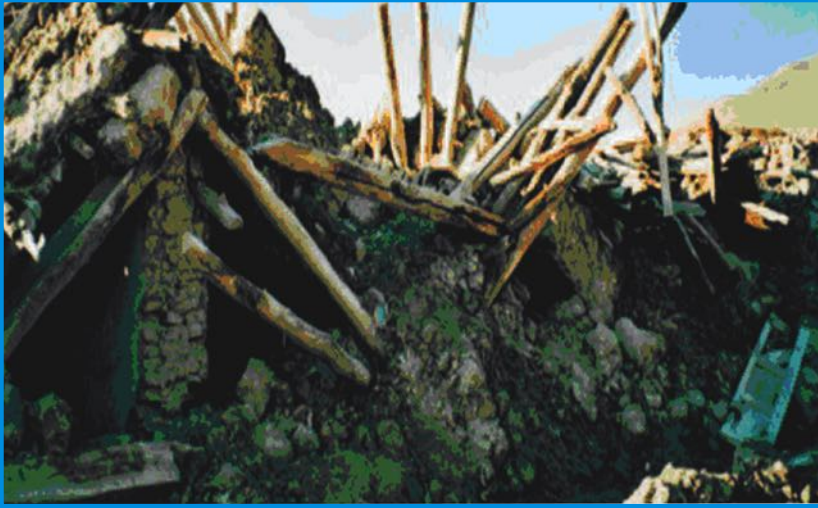
شکل (۲۹) تخریبات زلزله رستاق در شمال افغانستان
