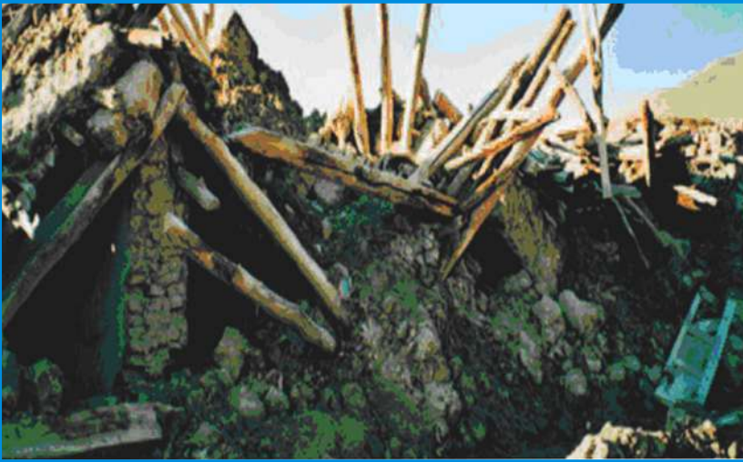
شکل (۹۷) تخریبات زلزله رستاق در شمال افغانستان
